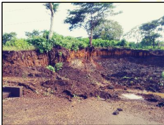
Imagen 7 Sitio del proyecto en el que se observa la cárcava de la cual se extrajo material selecto
